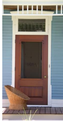
Porte en menuiserie d'assemblage avec vitrage et à large imposte 26, rue Pierre-Boucher
